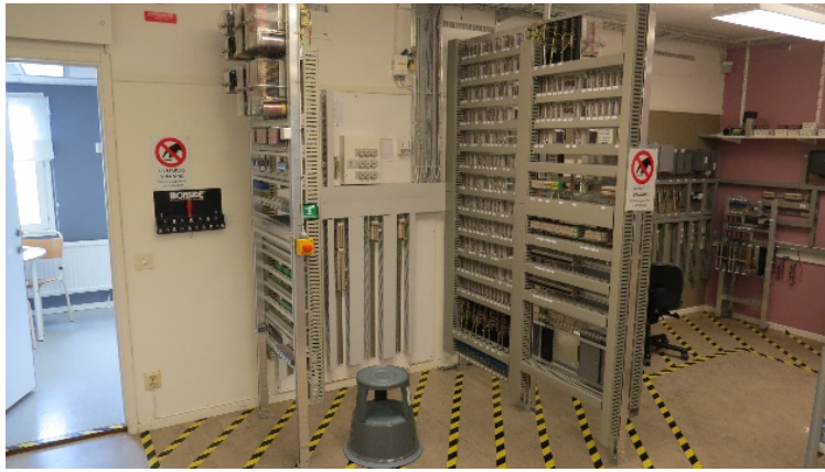
Del av ställverk 59
