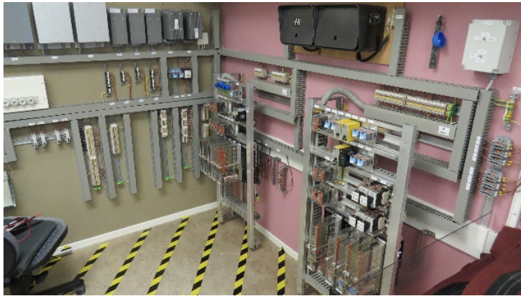
Styrutrustning till vägskydd med FK-låda
